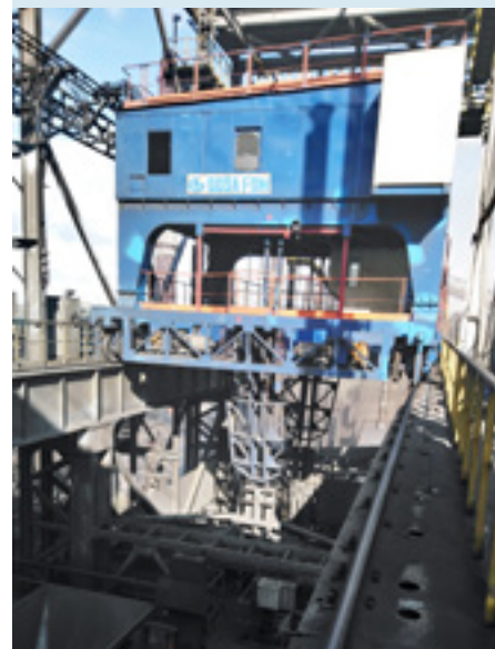
* Подизач за суво гашење кокса ОАО „Северстаљ”
