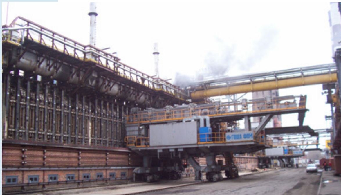
* Изгуривач кокса, 21,6 \text{ м}^3 , ОАО „Северстаљ”
